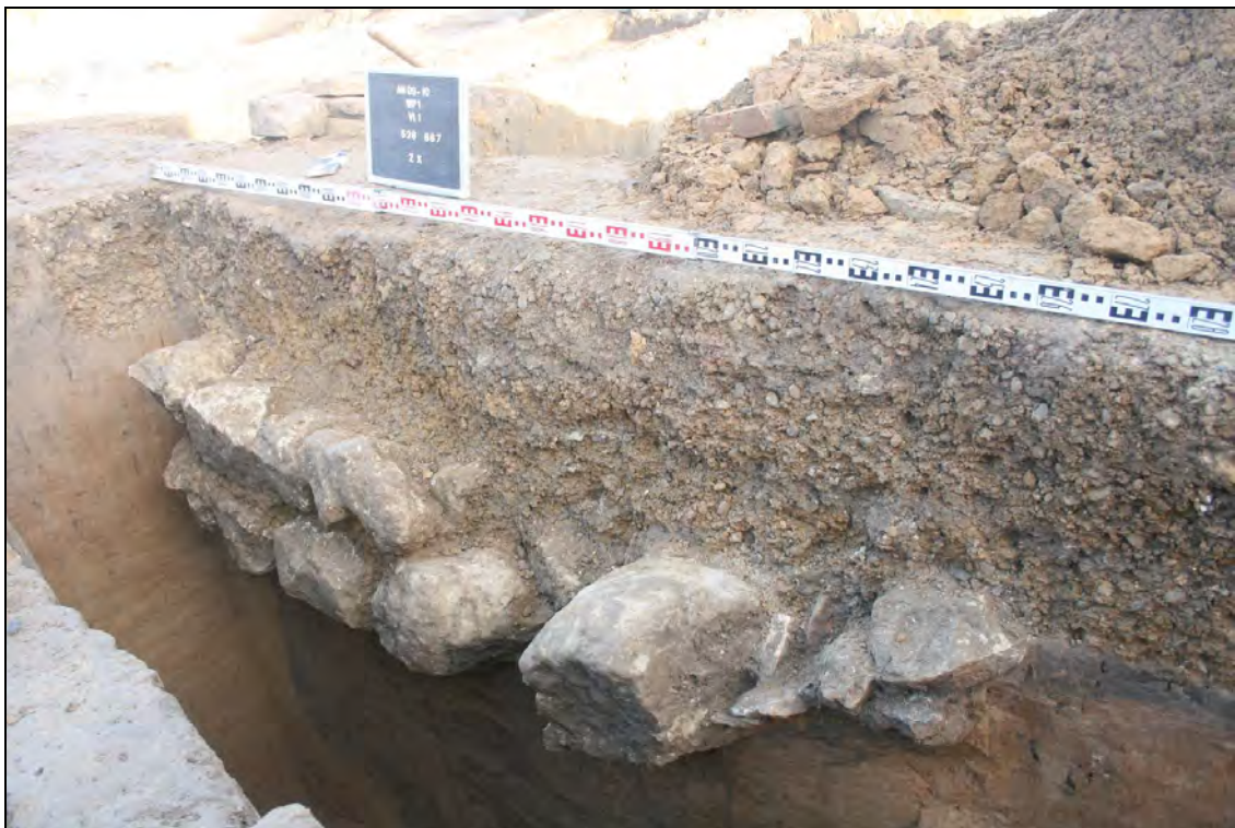
Fig. 2 - Op sommige plaatsen werd het gebouw dieper en sterker gefundeerd door middel van grote blokken kalkzandsteen (© Kristine Magerman – K.U. Leuven).
